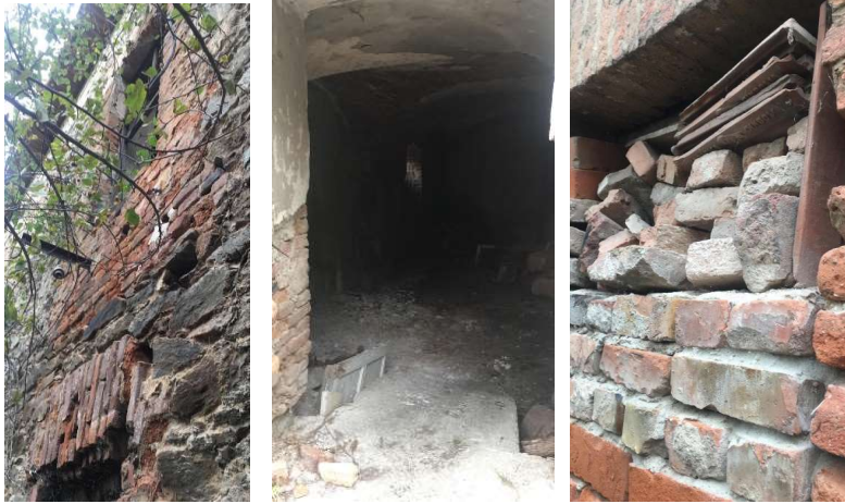
Figura 6 Deteriorări vizibile ale Clădiri administrative a SPMN
